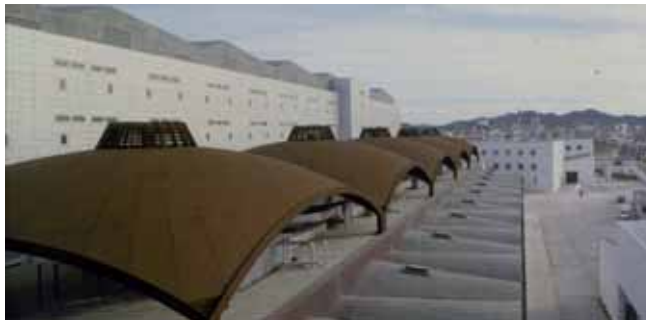
Figura 6.27. Instalaciones en cubierta sobre el bloque quirúrgico.
