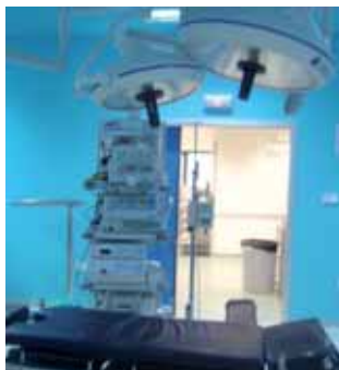
Figura 6.18. Quirófano: disposición de equipamiento (3).
