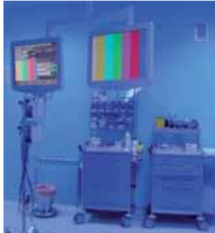
Figura 6.20. Quirófano: disposición de equipamiento (5).
