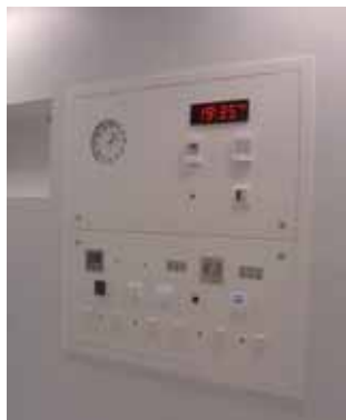
Figura 6.15. Quirófano: panel técnico.
