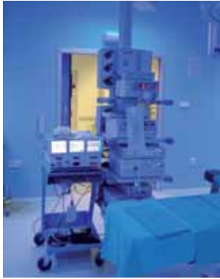
Figura 6.19. Quirófano: disposición de equipamiento (4).
