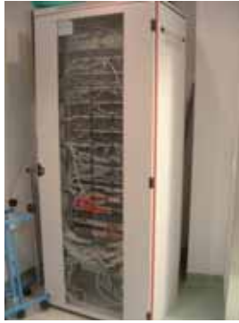
Figura 6.13. Sala técnica de instalaciones de seguridad eléctrica.
