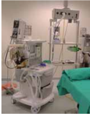
Figura 6.22. Quirófano: disposición de equipamiento (7).
