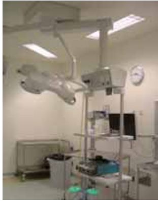
Figura 6.16. Quirófano: disposición de equipamiento (1).
